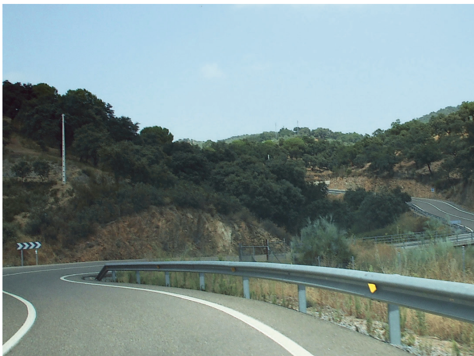
Los desmontes realizados en la carretera dificultan la intervisibilidad en sentido oblicuo.
