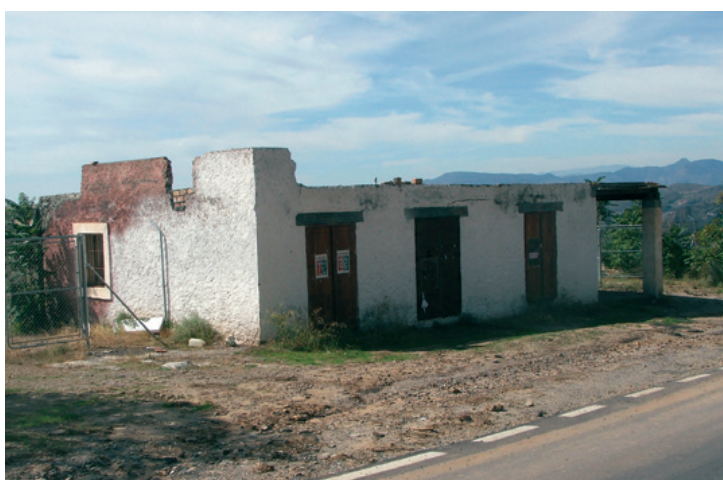
Hay algunas edificaciones junto a la carretera que reclaman actuaciones de restauración o demolición, según los casos.
